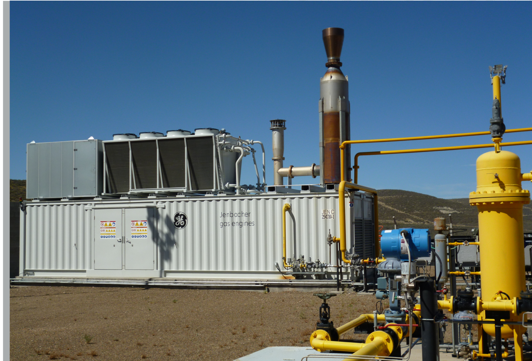
Generador de Planta de Hidrógeno, Chubut
