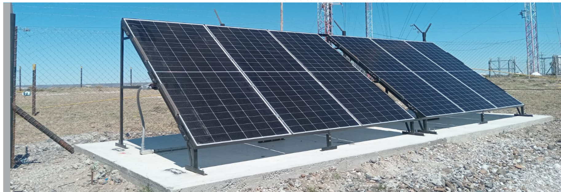
Paneles solares en instalaciones alejadas, Chubut
